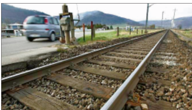
Les traverses pouvant recevoir le 3 e rail seront déjà posées cet été dans le cadre du renouvellement de la voie entre Bassecourt et Glovelier par les CFF. ARCHIVE ROGER MEIER
